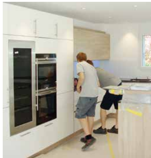
Beim Neubau des Mehrfamilienhauses Bischoff in Goldach war die Abteilung Installation unter anderem verantwortlich für die komplette LED-Beleuchtung.
