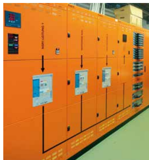
Die Elektroverteilung ist das Herz jeder Elektroinstallation.
