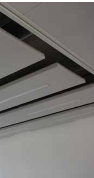
Spezielle Kühldecken sorgen für angenehmes Raumklima.
