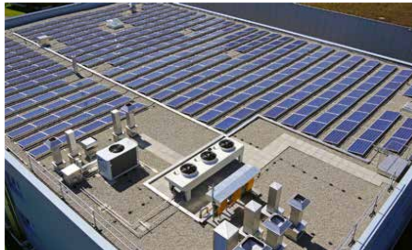
Referenzobjekte der Eigenmann AG in Wittenbach
